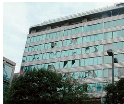
福岡を襲った地震で窓ガラスの破損による二次災害が心配されました。
