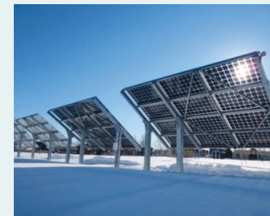
PVG Solutions(株) 両面発電太陽電池システム
