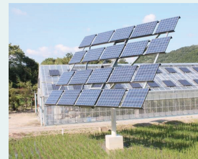
フジプレミアム(株) 追尾型太陽電池システム
