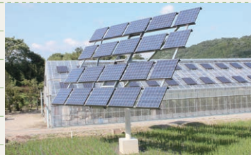
トラッキング太陽光発電システム
