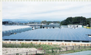
設置完了した、当社太陽光発電システム
