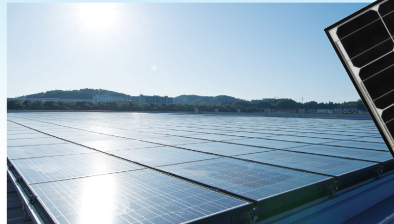
すでに光都PV工場の屋上部分にもさまざまな太陽光発電システムが設置されていますが、発電効率、耐久性ともに格段に向上しています。
